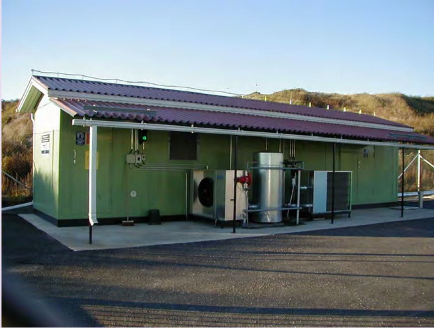
Рисунок 74. Компрессорная станция для сбора биогаза.
